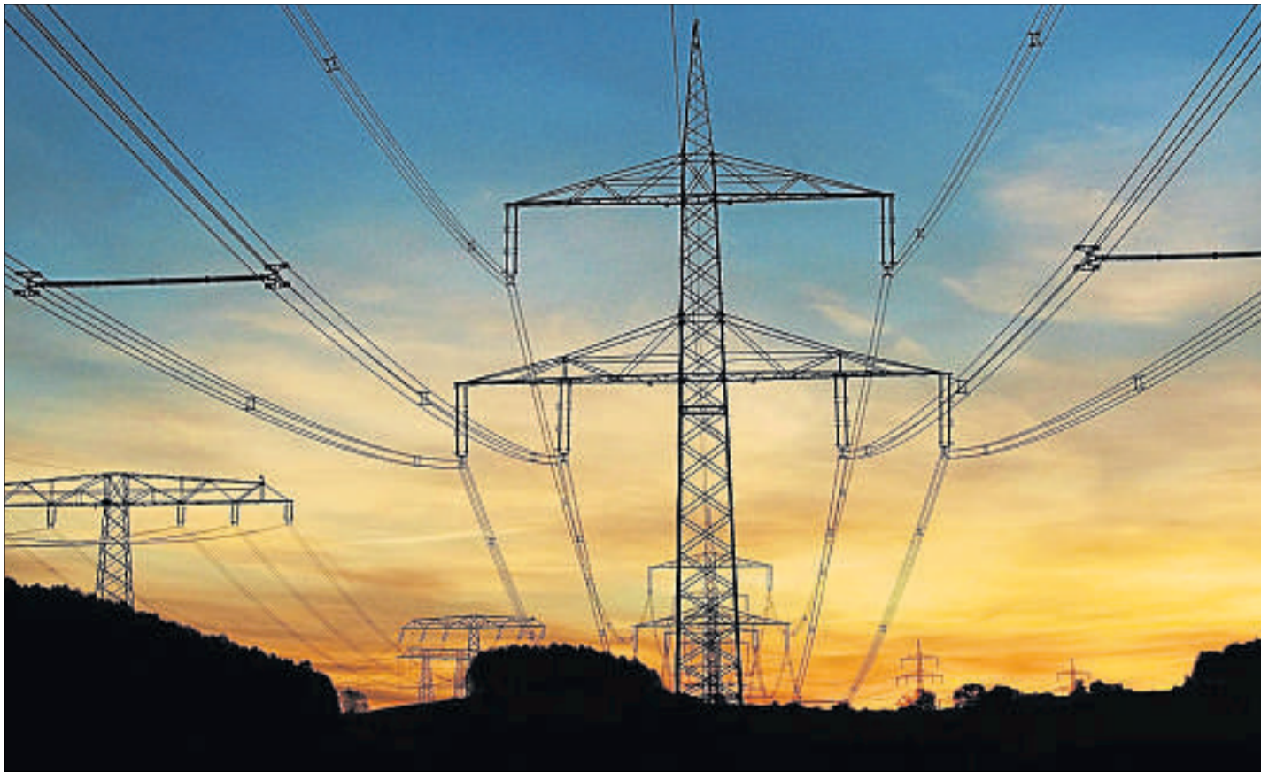
Stromleitungen im Morgenlicht: Weil die Konzessionsverträge auslaufen, haben Kommunen die Chance, die Energieversorgung selbst zu gestalten. Nun machen sich auch Grüne im Raum Göttingen und Nordhessen für die Idee stark. Foto: dpa
