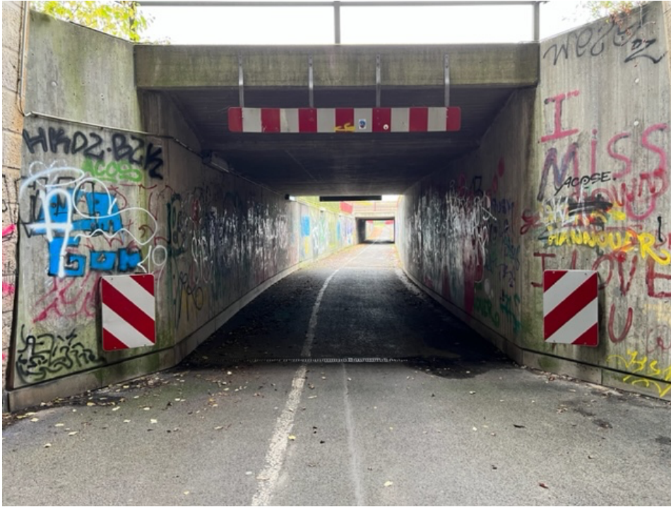
Foto: Eingang des Tunnels, aktueller unansehnlicher Zustand
